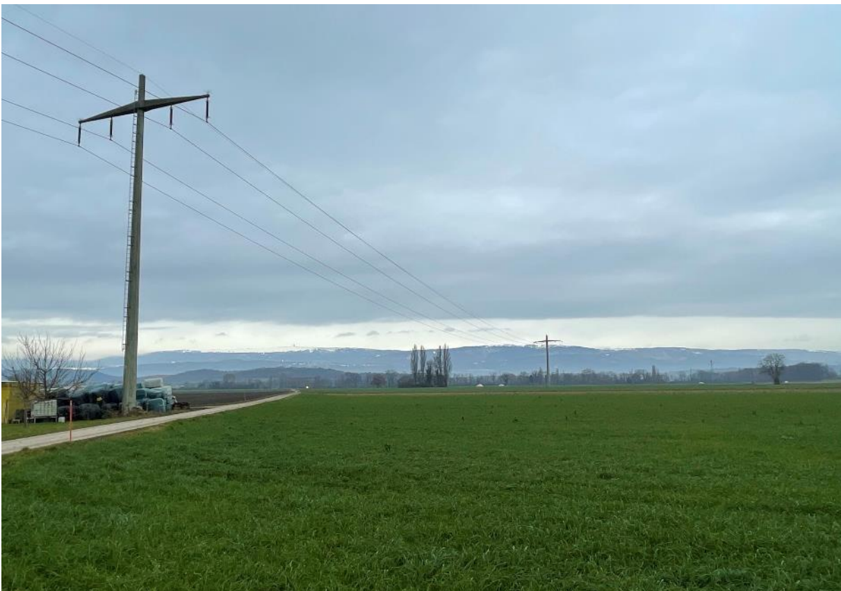
Blick Richtung Nordwest ins Grosses Moos mit Freileitungen
