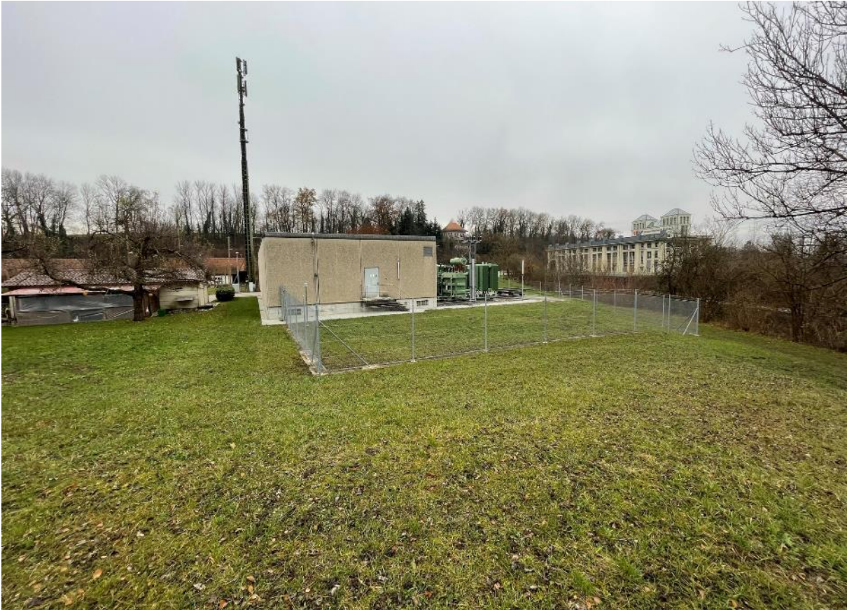
Unterstation mit Ersatzfläche 4 für Erneuerung
